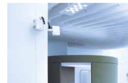
Condairs luftbefugtningssystem NanoFog Evolution i Fraunhofer IAO
